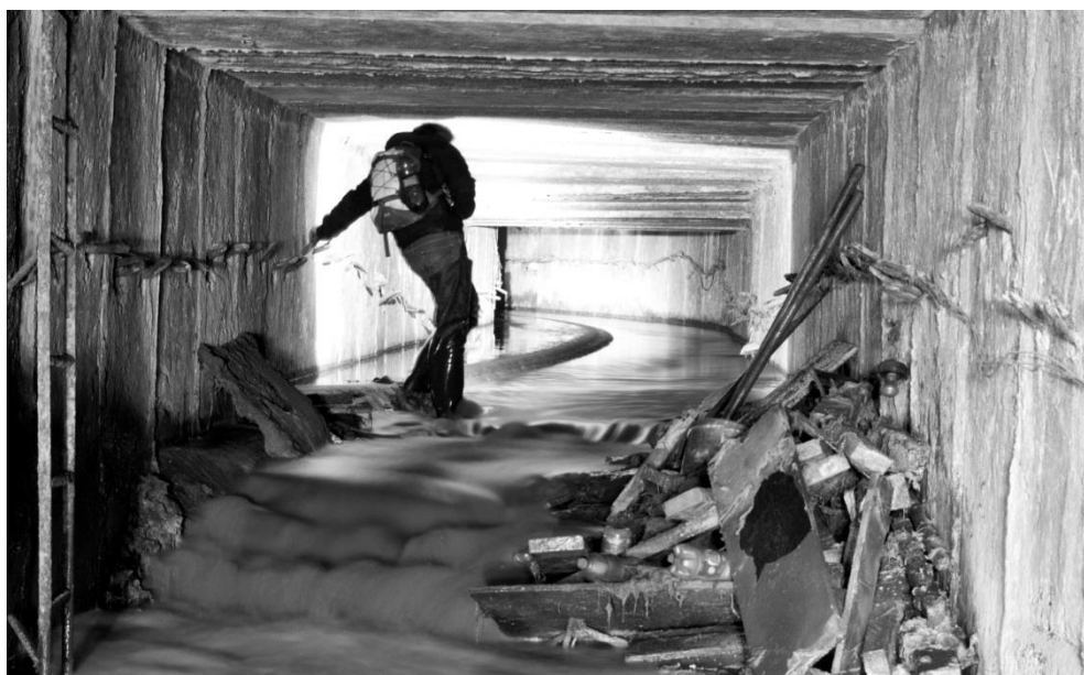
Рис. 2. Мощная техноаллювиальная толща в коллекторе Таракановки. Изначальная высота коллектора — 3,2 м, оставшийся зазор — около 1,5–1,6 м. Фото В.А. Неходцева
